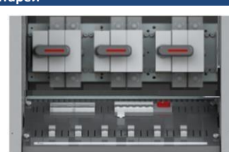
Тип F Батарейные разъединители-предохранители на панели подключения батарей
